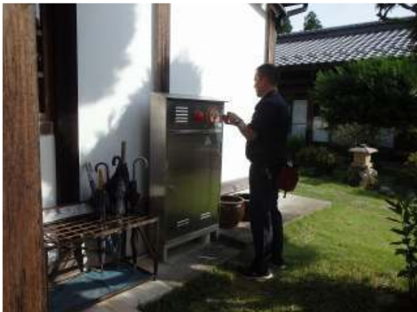
長蔵寺 防火点検
